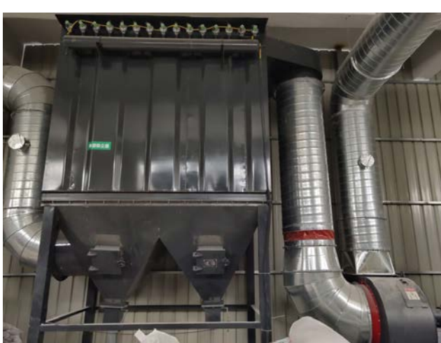
粉尘处理设施
