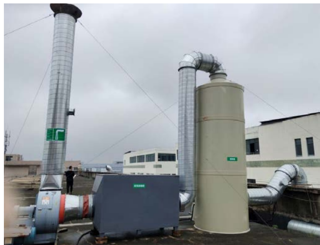
有机废气处理设施
