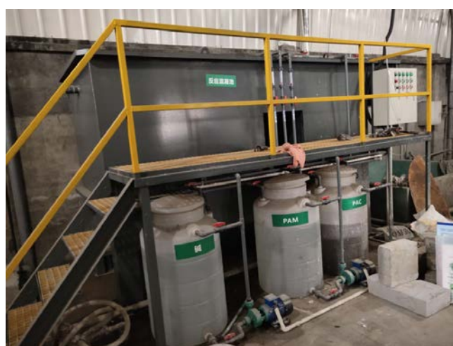
废水处理设施
